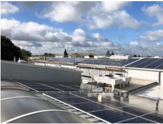
Überblick über die Dächer mit den Solaranlagen
