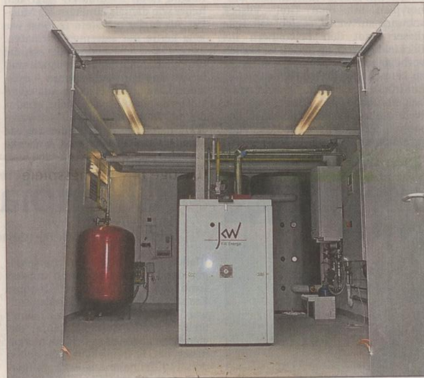
Das Blockheizkraftwerk ist auf einem Firmengrundstück in Schnaittenbach gegenüber dem alten Bahnhof untergebracht. Bild: hzf
